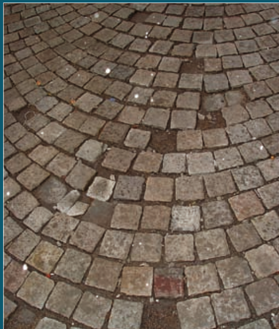
Pavage de la place Monseu à Ciney, à proximité de la collégiale et autour du kiosque, tous les deux monuments classés, la place elle-même étant classée comme site depuis 1976. Les pavés de grès clair asiatique mis en œuvre en 1999 se délitent en grosses écailles, ruinant tout l'ouvrage.
