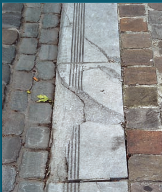
Aménagement des abords de la "Tour noire" (classée comme monument), derrière l'église Sainte-Catherine à Bruxelles, réalisé en 2000. Les bordures, en calcaire cristallin très clair provenant du Vietnam, se sont inexorablement dégradées en peu de temps, pour des raisons intrinsèques mal connues.
