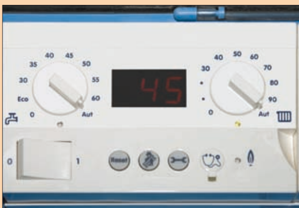
Panneau de commande de la chaudière basse température au mazout
