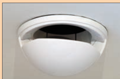
Bouche de pulsion du système de ventilation mécanique avec récupération de chaleur
