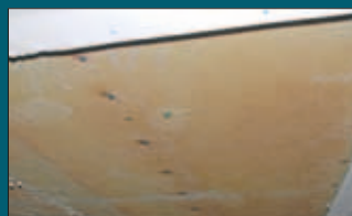
Après l'enlèvement des plaques PROMATECT®-100, le panneau en bois ne présente aucune trace de calcination ou d'inflammation
